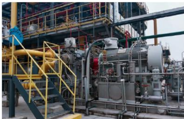
图2 净化厂余压发电装置
